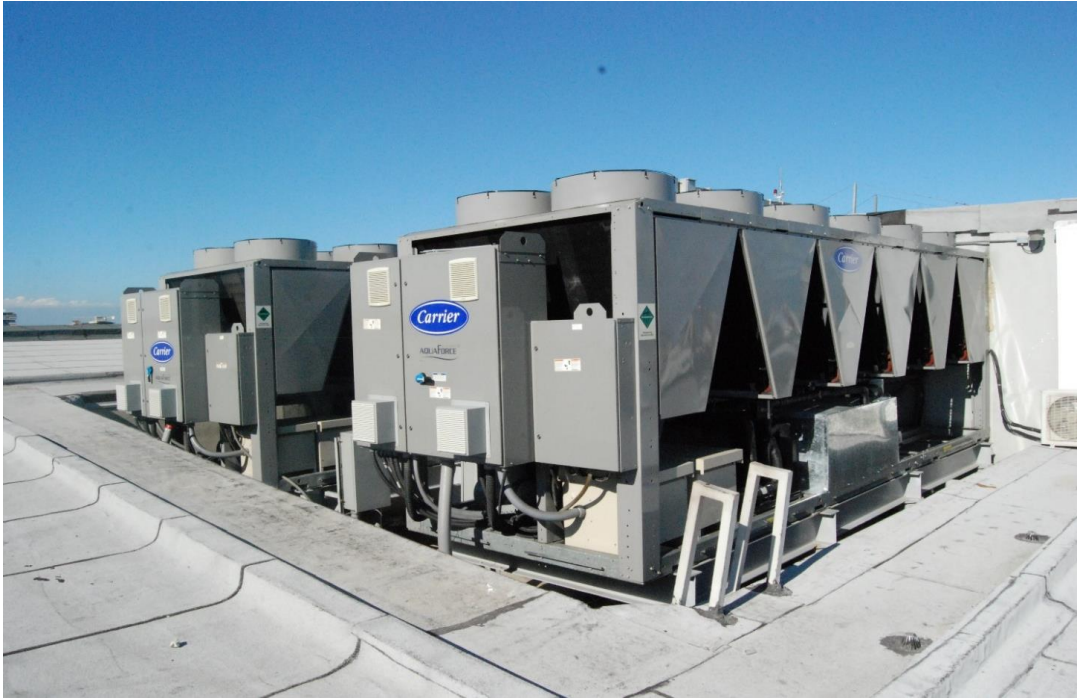
DESCRIPCIÓN DE LA PROPIEDAD. SISTEMA DE CLIMATIZACIÓN.
