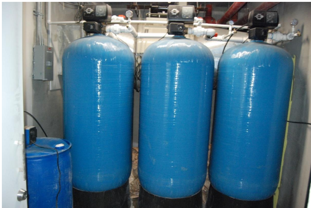
DESCRIPCIÓN DE LA PROPIEDAD. SISTEMA BOMBEO Y TRATAMIENTO DE AGUA GRUDA.
